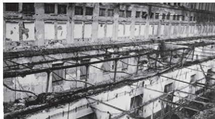
Wypalona hala tkalni – widok od południa; w głębi widoczna ściana budynku administracyjnego (A. Weber budynek administracyjny nazywa w swym tekście „budynek frontowym”). Przed wojną w budynku tym mieściły się na dolnych piętrach wydziały produkcyjne, m.in. pomieszczenia brakarzy, obecnie – „Biedronka”. Zdjęcie A. Stuglika w zbiorach AP w Katowicach Oddział Oświęcim.
