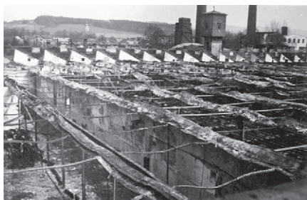
Widok od zachodu na całkowicie wypaloną halę tkalni; w głębi charakterystyczny szedony dach wykańczalni. Zdjęcie A. Stuglika w zbiorach AP w Katowicach Oddział Oświęcim.
